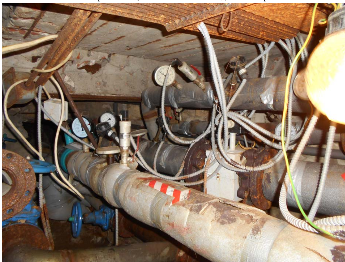
34. УУТ в тех канале под полом первого этажа
