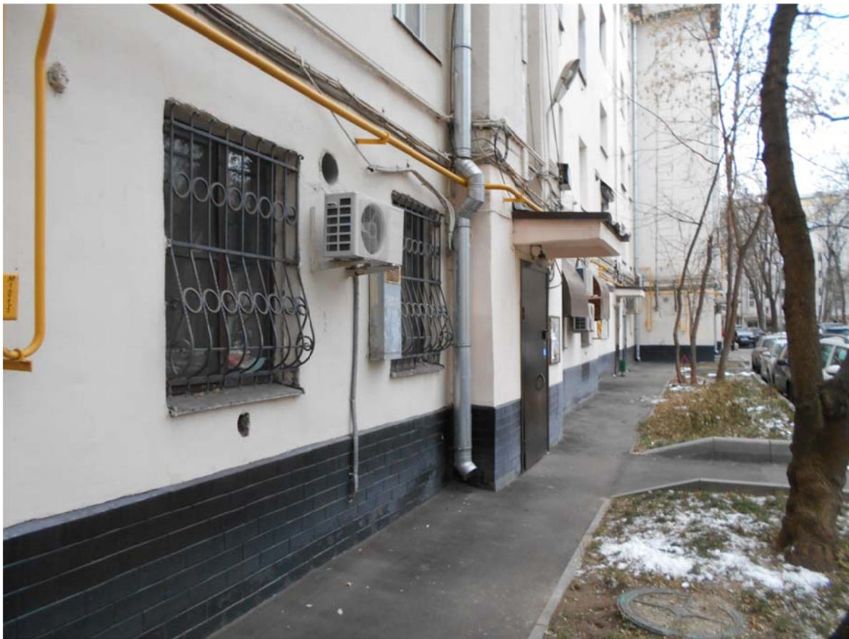
11. Входная группа 2-го подъезда, состояние отмостки
