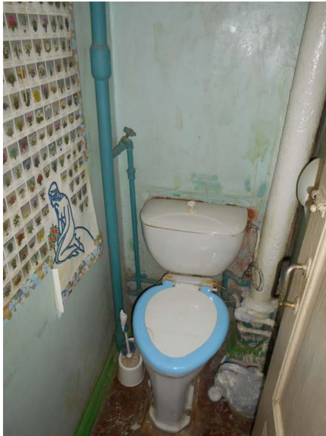
35. Трубы систем водоснабжения в санузле
