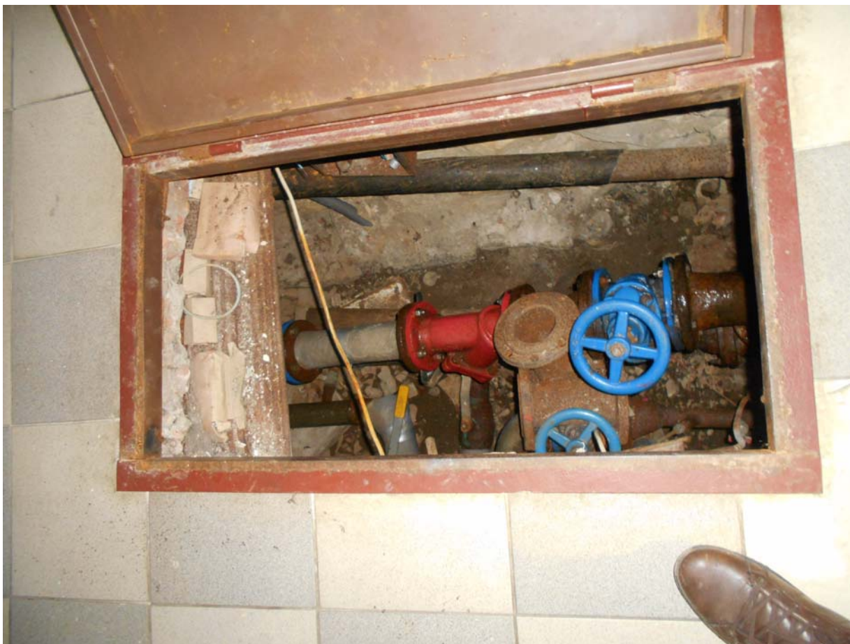
33. Магистралы ХВС, ГВС в тех канале под полом первого этажа
