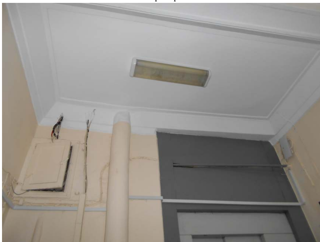
40. Осветительный прибор приквартирного холла
