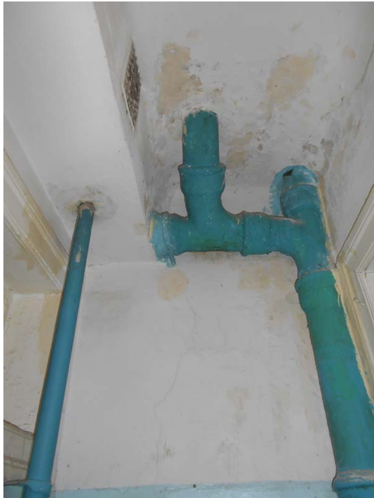
36. Стояк системы К1 в санузле
